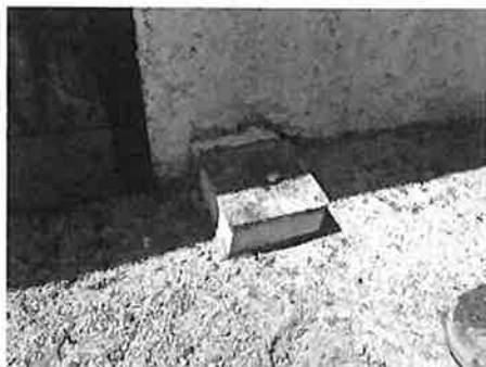
regard situé en amont de la fosse toutes eaux du gite
