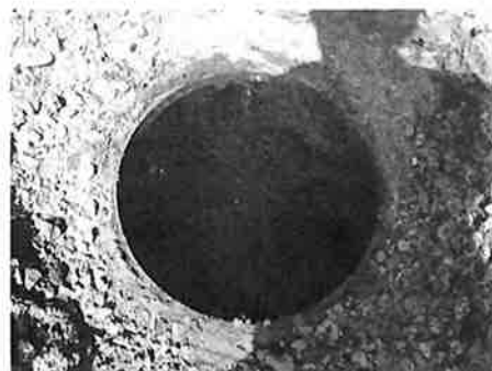
Fosse toutes eaux du gite
