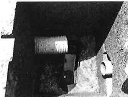
1 er regard intermédiaire (de collecte) après la fosse du gite
