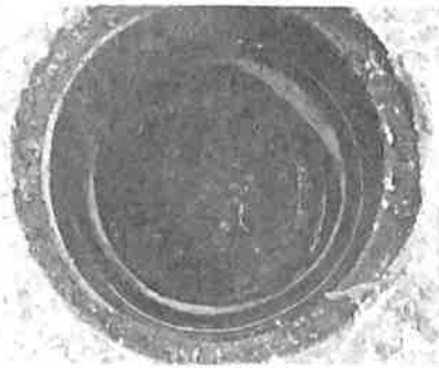
Fosse toute-eaux (colmatée) de l'habitation
