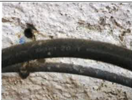
Photo n° 1684G3 Localisation : Garage Lyre 2001, date limite d'utilisation dépassée.
