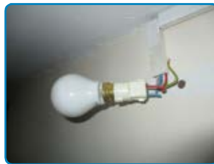
Anomalie B.8.3 b sur Install. n°1
