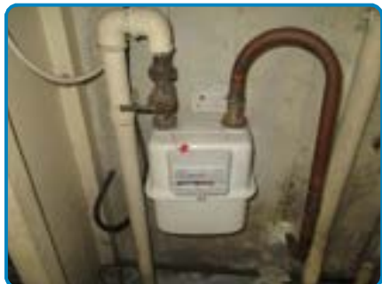
Installation n°1 (Gaz naturel) (dans Maison Rez de chaussée Garage)
