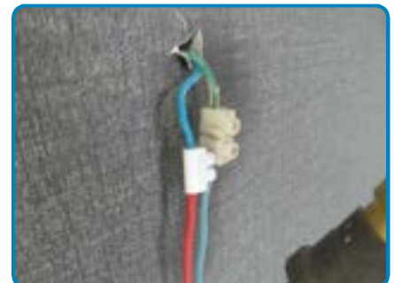
Anomalie B.7.3 d sur Install. n°1
