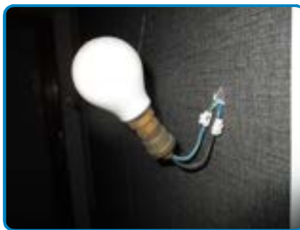
Anomalie B.8.3 a sur Install. n°1
