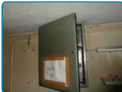
Anomalie B.3.3.9 b sur Install. n°1
