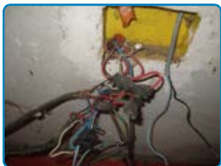
Anomalie B.8.3 e sur Install. n°1
