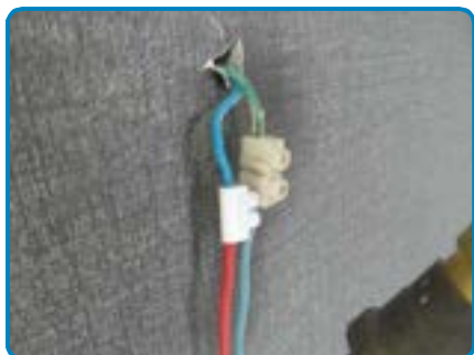
Anomalie B.8.3 e sur Install. n°1
