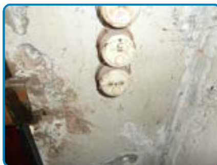
Anomalie B.8.3 a sur Install. n°1
