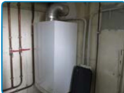
Appareil n°2 (Chaudière chauffage) sur installation n°1 (dans Maison Rez de chaussée Local chaudière)
