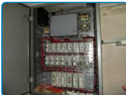
Anomalie B.4.3 b sur Install. n°1 App. n°1 (TRP n°1)
