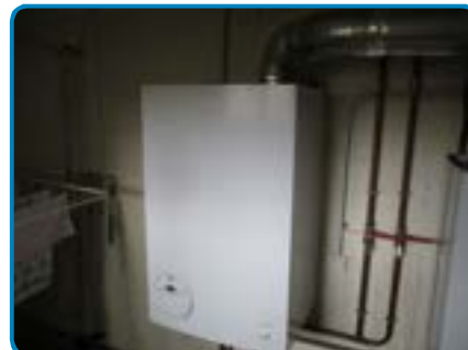
Appareil n°1 (Chaudière chauffage) sur installation n°1 (dans Maison Rez de chaussée Local chaudière)
