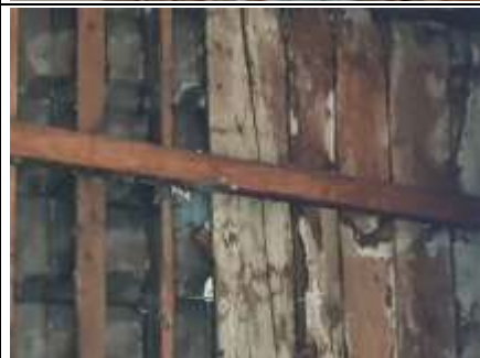
Photo n° 1524T2 Localisation sur croquis : Toiture Ouvrage : volige présence désordre lié à la pathologie humide
