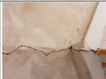
Photo n° 1524T4 Localisation sur croquis : dégagement 1, niveau 4 Ouvrage : plafond: présence de fissure.
