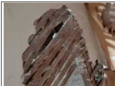
Photo n° 1524T1 Localisation sur croquis : niveau 4 Indices : lattis apparent
