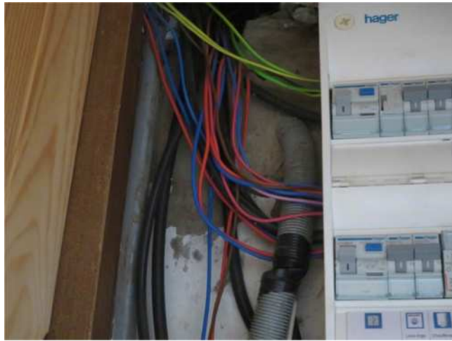
Conducteurs non protégés tableau de répartition
