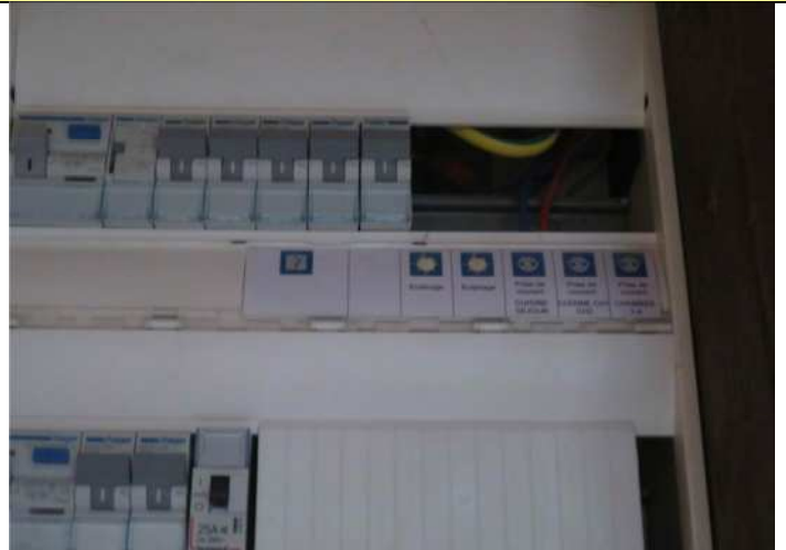
Absence de cache tableau de répartition
