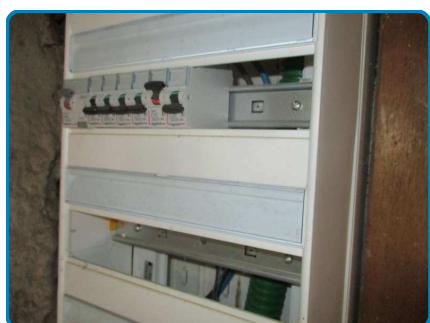
Anomalie B.7.3 a sur Install. n°1 App. n°1 (TRP n°1)
