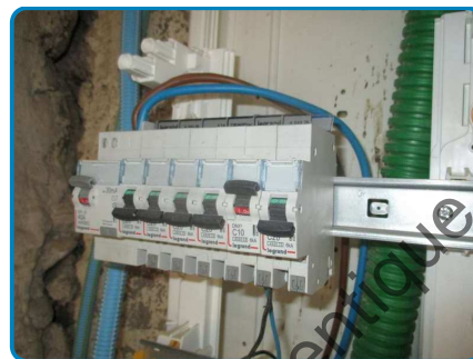
TRP n°1 sur Install. n°1 (dans Rez de chaussée Séjour coin cuisine)
