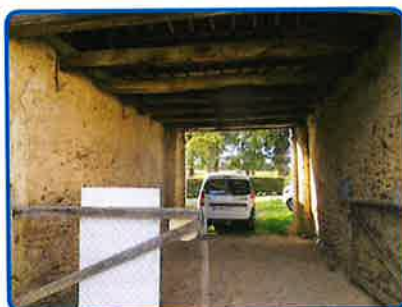
Rez de chaussée Porche
