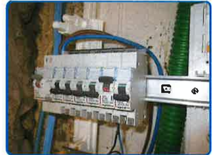
TRP n°1 sur Install. n°1 (dans Rez de chaussée Séjour coin cuisine)
