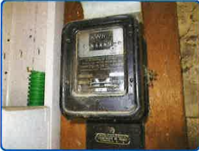
COMPTEUR sur Install. n°1 (dans Rez de chaussée Séjour coin cuisine)
