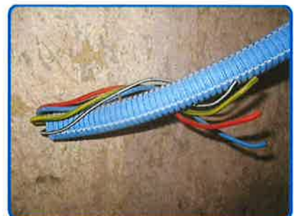
Anomalie B.8.3 e sur Install. n°1
