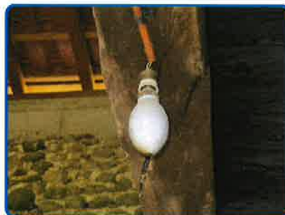
Anomalie B.3.3.6 a3 sur Install. n°1 Anomalie B.8.3 a sur Install. n°1
