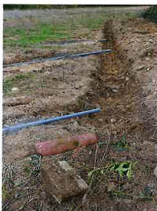
Arrivées des eaux usées brutes en surface sur les tranchées – 1
