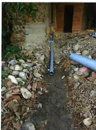
Sortie des eaux ménagères brutes et des urines collectées (déclarations de la propriétaire)
