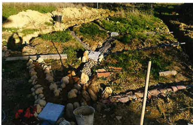
Fermeture des fouilles des canalisations de transports des eaux usées brutes. Il est possible de constater que le débouché de ces canalisations se situe à l'air libre
