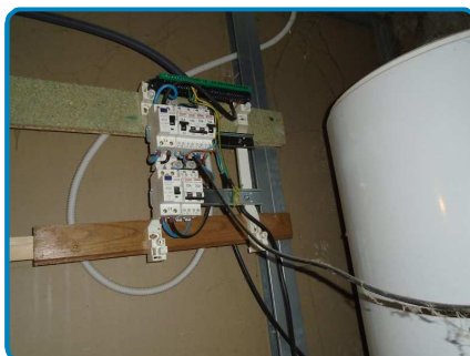
Anomalie B.4.3 f2 sur Install. n°1 App. n°3 (TRS n°3)
