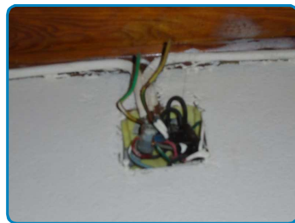
Anomalie B.7.3 d sur Install. n°1
