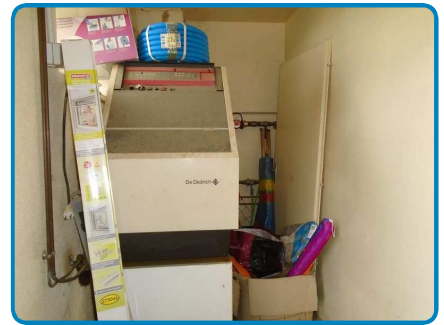
Dépendance Rez de chaussée Chaufferie
