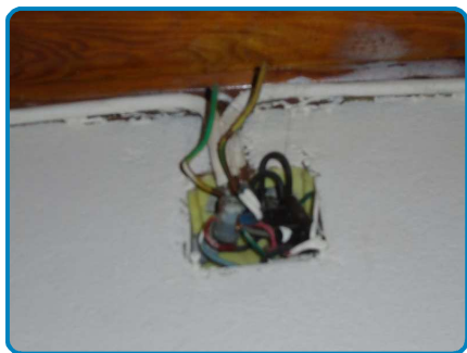
Anomalie B.7.3 c2 sur Install. n°1
