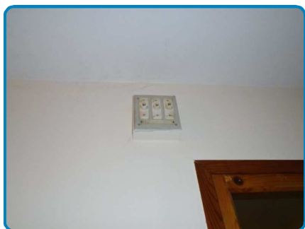
Anomalie B.7.3 e sur Install. n°1
