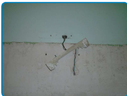
Anomalie B.8.3 e sur Install. n°1
