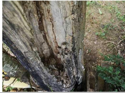
Photo n° PhTer002 Localisation : extérieur - bois Ouvrage : Sol - bois Parasite : Présence d'indices d'infestation de termites, Termites souterrains Indices : altérations dans le bois
