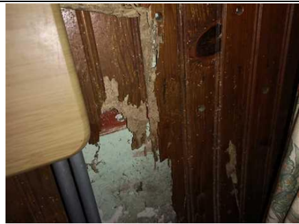
Photo n° PhTer001 Localisation : Rez de chaussée - séjour et cuisine 3 Ouvrage : Mur - A, B, C, D, E - pierre de taille et lambris Bois Parasite : Présence d'indices d'infestation de termites, Termites souterrains Indices : altérations dans le bois
