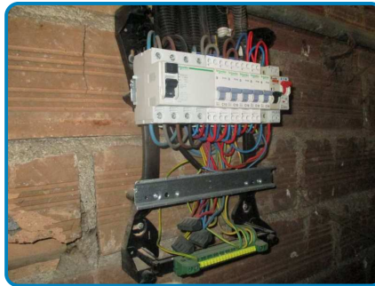
TRS n°1 sur Install. n°1 (dans Maison principale Rez de chaussée Pièce n°1)
