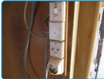
Anomalie B.3.3.6 a2 sur Install. n°1 Anomalie B.7.3 e sur Install. n°1
