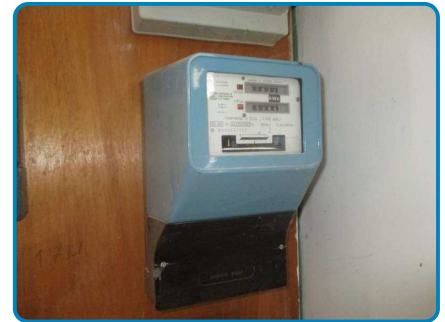
COMPTEUR sur Install. n°1 (dans Maison principale Rez de chaussée Salon)
