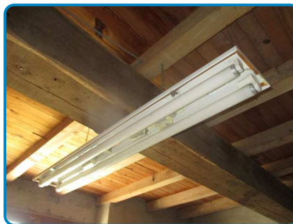
Anomalie B.7.3 a sur Install. n°1
