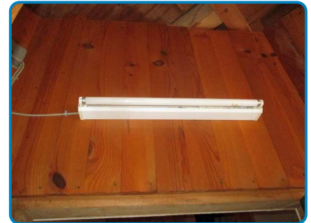
Anomalie B.3.3.6 a3 sur Install. n°1
