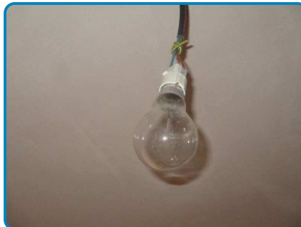
Anomalie B.8.3 b sur Install. n°1
