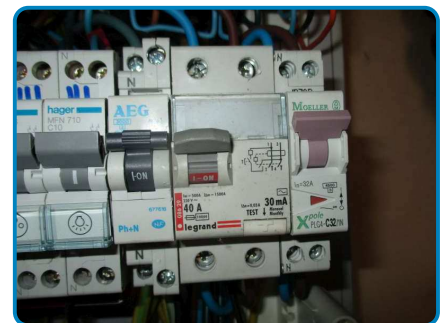
Anomalie B.2.3.1 i sur Install. n°1 (PROTEC.DIFF.) Anomalie B.2.3.1 h sur Install. n°1 (PROTEC.DIFF.)
