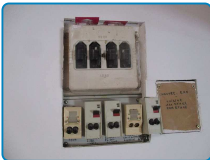
Anomalie B.3.3.6.1 sur Install. n°1 Anomalie B.3.3.6.1 sur Install. n°1
