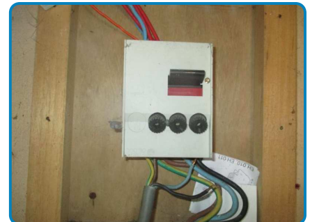
Anomalie B.8.3 e sur Install. n°1
