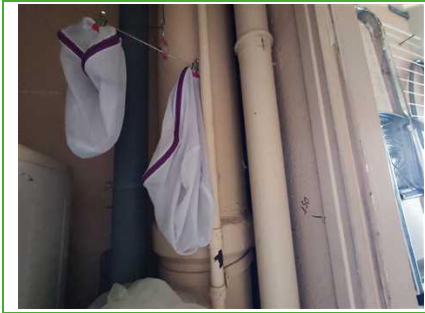
Photo n° PhA001 Localisation : 3ème étage - buanderie Ouvrage : 6 - Conduits et accessoires intérieurs - Conduits de fluides (air, eau, vapeur, fumée, échappement, autres fluides) Partie d'ouvrage : Conduit en fibres-ciment Description : Conduit en fibres-ciment Localisation sur croquis : M001
