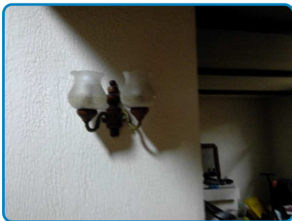
Anomalie B.3.3.6 a3 sur Install. n°1
