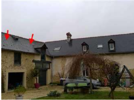
Photo n° PhA002 Localisation : Parties extérieures Ouvrage : Toitures Partie d'ouvrage : Ardoises (composites) Description : Ardoises (composites) Localisation sur croquis : ZPSO-002
