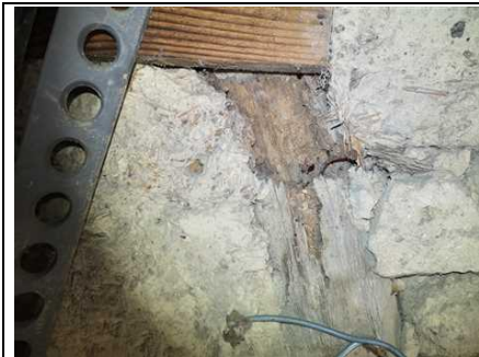
Photo n° PhTer001 Localisation : Rez de chaussée - cellier extérieur Ouvrage : Mur - enduit, colombages et brut Parasite : Présence d'indices d'infestation de termites, Termites souterrains Indices : altérations dans le bois, bois d'apparence feuilleté, dégradation du bois, présence de cordonnets
