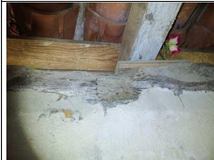
Photo n° PhTer002 Localisation : Rez de chaussée - cellier extérieur Ouvrage : Plafond - charpente bois, tuiles et brut Parasite : Présence d'indices d'infestation de termites, Termites souterrains Indices : altérations dans le bois, bois d'apparence feuilleté, dégradation du bois
