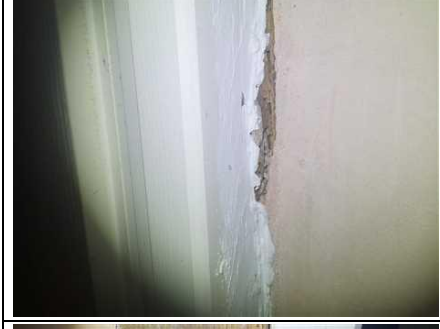
Photo n° PhTer003 Localisation : Rez de chaussée - Wc Ouvrage : Bati porte - A - Bois et Peinture Parasite : Présence d'indices d'infestation de termites, Termites souterrains Indices : altérations dans le bois, bois d'apparence feuilleté, dégradation du bois
