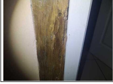
Photo n° PhTer004 Localisation : Rez de chaussée - cellier Ouvrage : Bati porte - A - Bois et Peinture Parasite : Présence d'indices d'infestation de termites, Termites souterrains Indices : altérations dans le bois, bois d'apparence feuilleté, dégradation du bois
