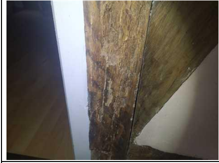
Photo n° PhTer002 Localisation : Rez de chaussée - Séjour et Salle à manger Ouvrage : Mur - A, B, C, D - enduit et poutres bois et Peinture, brut Parasite : Présence d'indices d'infestation de termites, Termites souterrains Indices : altérations dans le bois, bois d'apparence feuilleté, dégradation du bois
