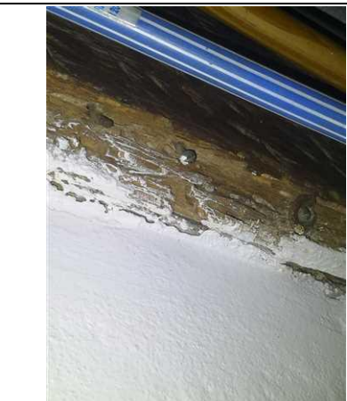
Photo n° PhTer002 Localisation : Rez de chaussée - buanderie Ouvrage : Mur - B - enduit, colombages et peinture et brut Parasite : Présence d'indices d'infestation de termites, Termites souterrains Indices : altérations dans le bois, dégradation du bois, présence de cordonnets
