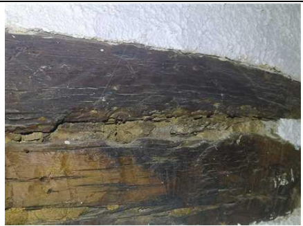
Photo n° PhTer001 Localisation : Rez de chaussée - Dégagement Ouvrage : Mur - D - enduit, colombages et Peinture et brut Parasite : Présence d'indices d'infestation de termites, Termites souterrains Indices : altérations dans le bois, dégradation du bois, présence de cordonnets
