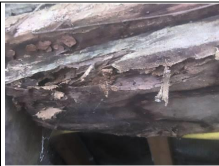
Photo n° PhTer001 Localisation : Rez de chaussée - Cellier 2 Ouvrage : Dormant de porte Parasite : Termites souterrains Indices : altérations dans le bois, galeries-tunnels Localisation sur croquis : 001
