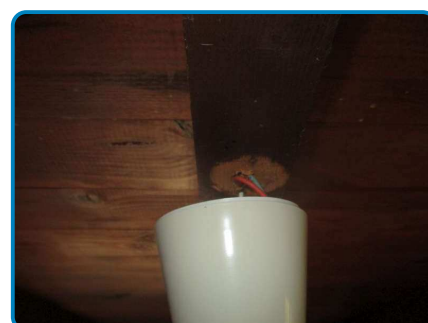
Anomalie B.3.3.6 a3 sur Install. n°1
