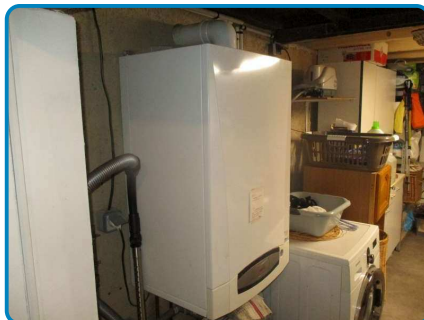
Appareil n°1 (Chaudière mixte) sur installation n°1 (dans Maison principale Rez de chaussée Buanderie)
