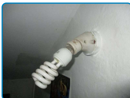
Anomalie B.8.3 a sur Install. n°1
