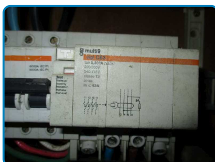
Anomalie B.2.3.1 i sur Install. n°1 (PROTEC.DIFF.) Anomalie B.2.3.1 h sur Install. n°1 (PROTEC.DIFF.) Anomalie B.1.3 b sur Install. n°1 (AGCP)
