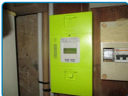
COMPTEUR sur Install. n°1 (dans Maison principale Rez de chaussée Buanderie)
