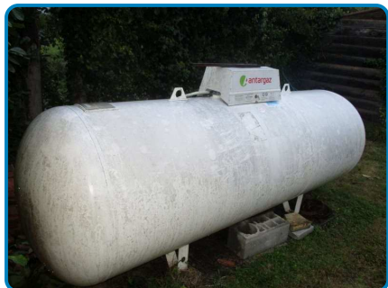
Installation n°1 (Propane) (dans Maison principale Rez de chaussée Extérieur)
