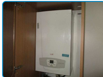
Appareil n°2 (Chaudière mixte) sur installation n°1 (dans Gîte Rez de chaussée Cuisine)
