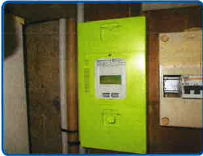
COMPTEUR sur Install. n°1 (dans Maison principale Rez de chaussée Buanderie)
