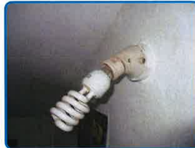
Anomalie B.8.3 a sur Install. n°1
