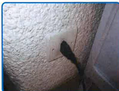
Anomalie B.3.3.6 a1 sur Install. n°1
