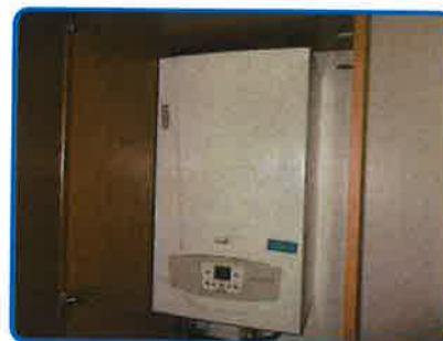
Appareil n°2 (Chaudière mixte) sur installation n°1 (dans Gîte Rez de chaussée Cuisine)
