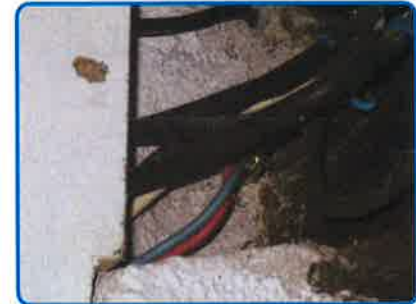
Anomalie B.8.3 e sur Install. n°1 Anomalie B.7.3 d sur Install. n°1
