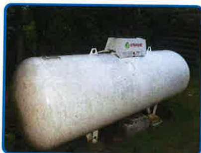
Installation n°1 (Propane) (dans Maison principale Rez de chaussée Extérieur)
