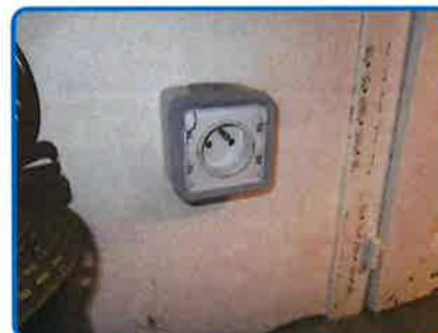
Anomalie B.3.3.6 a2 sur Install. n°1
