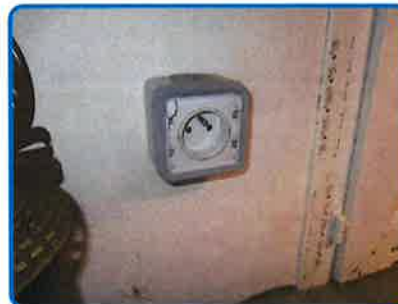
Anomalie B.3.3.6 a2 sur Install. n°1
