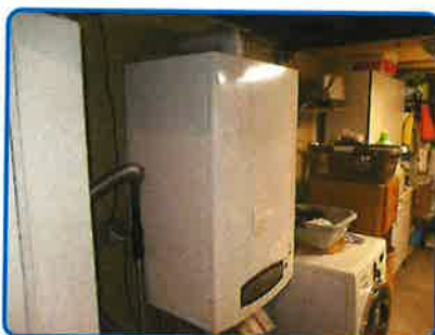
Appareil n°1 (Chaudière mixte) sur installation n°1 (dans Maison principale Rez de chaussée Buanderie)
