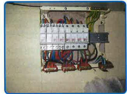
TRS n°1 sur Install. n°1 (dans Maison principale Rez de chaussée Cuisine)
