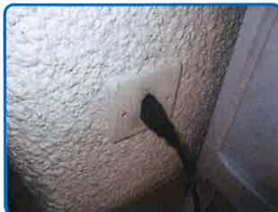
Anomalie B.3.3.6 a1 sur Install. n°1
