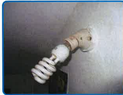
Anomalie B.8.3 a sur Install. n°1
