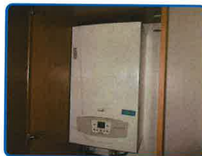
Appareil n°2 (Chaudière mixte) sur installation n°1 (dans Gîte Rez de chaussée Cuisine)
