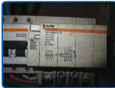
Anomalie B.2.3.1 i sur Install. n°1 (PROTEC.DIFF.) Anomalie B.2.3.1 h sur Install. n°1 (PROTEC.DIFF.) Anomalie B.1.3 b sur Install. n°1 (AGCP)
