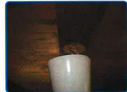
Anomalie B.3.3.6 a3 sur Install. n°1
