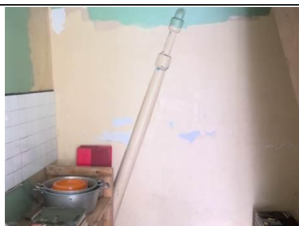
Photo n° PhA001 Localisation : Rez de chaussée - Cuisine Ouvrage : 6 - Conduits et accessoires intérieurs - Conduits de fluides (air, eau, vapeur, fumée, échappement, autres fluides) Partie d'ouvrage : Conduit en fibres-ciment Description : Conduit en fibres-ciment
