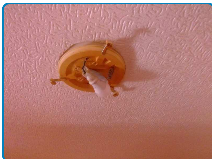
Anomalie B.7.3 a sur Install. n°1
