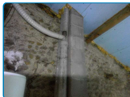
Conduit(s) de fluide gauche Fibres ciment / D (dans Maison principale 2ème étage Pièce) Conduit(s) de fluide droite Fibres ciment / D (dans Maison principale 2ème étage Pièce)
