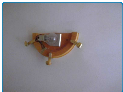
Anomalie B.7.3 a sur Install. n°1
