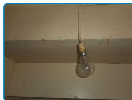
Anomalie B.8.3 b sur Install. n°1
