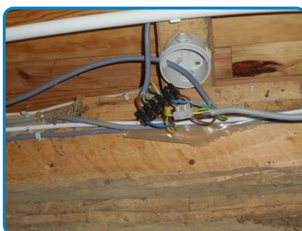
Anomalie B.7.3 a sur Install. n°1 Anomalie B.7.3 d sur Install. n°1
