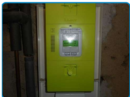
COMPTEUR sur Install. n°1 (dans Maison principale Rez de chaussée Atelier)
