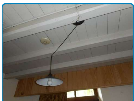
Anomalie B.3.3.6 a3 sur Install. n°1
