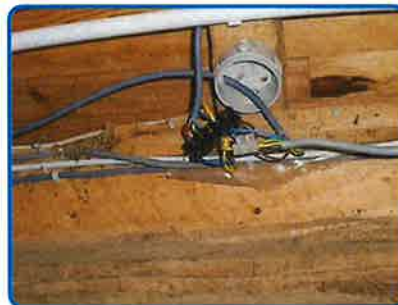
Anomalie B.7.3 a sur Install. n°1 Anomalie B.7.3 d sur Install. n°1
