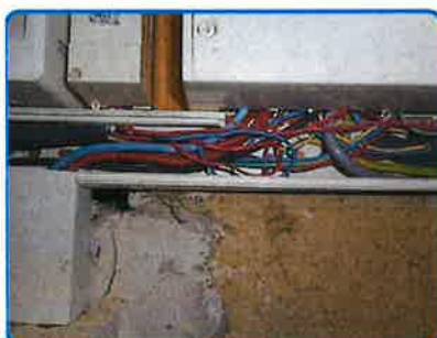
Anomalie B.8.3 e sur Install. n°1
