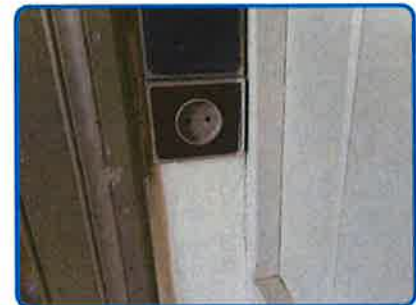
Anomalie B.3.3.6 a1 sur Install. n°1
