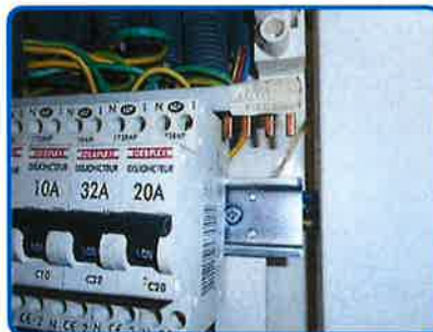
Anomalie B.7.3 d sur Install. n°1 App. n°1 (TRP n°1)
