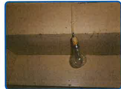
Anomalie B.8.3 b sur Install. n°1
