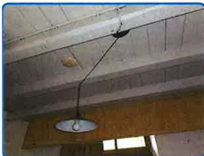
Anomalie B.3.3.6 a3 sur Install. n°1
