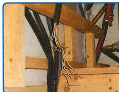
Anomalie B.8.3 e sur Install. n°1
