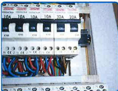
Anomalie B.4.3 e sur Install. n°1 App. n°1 (TRP n°1)
