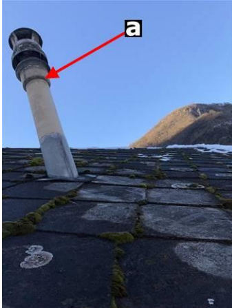
Photo n° PhA013 Localisation : Toiture - Couverture Ouvrage : Conduits en toiture et façade Partie d'ouvrage : Conduits de fumée en amiante-ciment Description : Conduits de fumée en amiante-ciment Localisation sur croquis : ZPSO-013
