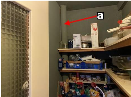
Photo n° PhA007 Localisation : 2ème étage - Cellier 4 Ouvrage : Conduits de fluides (air, eau, autres fluides) Partie d'ouvrage : Conduits Description : Conduits Localisation sur croquis : ZPSO-007
