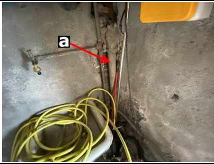
Photo n° PhA004 Localisation : Rez de chaussée - Garage Ouvrage : Conduits en toiture et façade Partie d'ouvrage : Conduits de fumée en amiante-ciment Description : Conduits en amiante-ciment Localisation sur croquis : ZPSO-004
