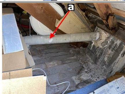
Photo n° PhA011 Localisation : Combles - Grenier Ouvrage : Conduits de fluides (air, eau, autres fluides) Partie d'ouvrage : Conduits Description : Conduits Localisation sur croquis : ZPSO-011
