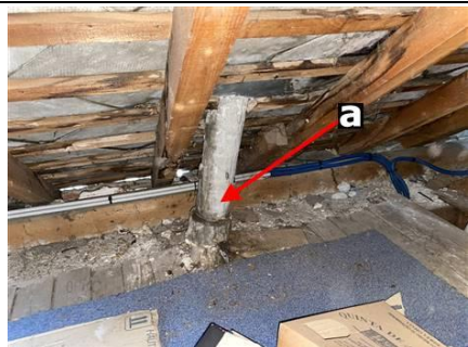
Photo n° PhA010 Localisation : Combles - Grenier Ouvrage : Conduits de fluides (air, eau, autres fluides) Partie d'ouvrage : Conduits Description : Conduits Localisation sur croquis : ZPSO-010
