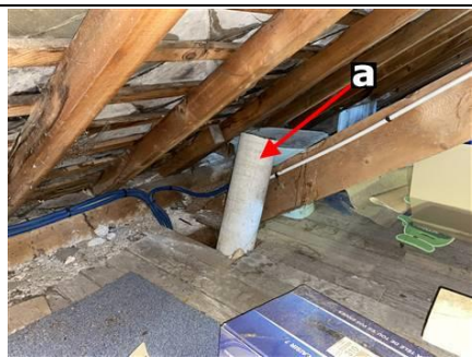
Photo n° PhA009 Localisation : Combles - Grenier Ouvrage : Conduits de fluides (air, eau, autres fluides) Partie d'ouvrage : Conduits Description : Conduits Localisation sur croquis : ZPSO-009
