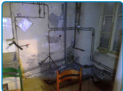
Maison principale Rez de chaussée Chaufferie
