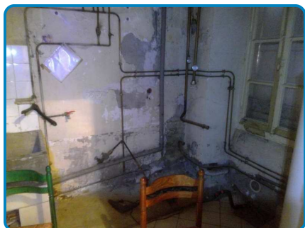
Maison principale Rez de chaussée Chaufferie
