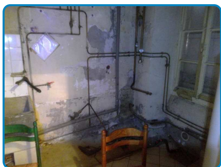
Maison principale Rez de chaussée Chaufferie
