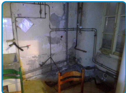
Maison principale Rez de chaussée Chaufferie
