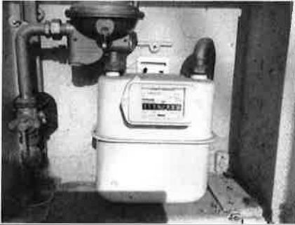
Photo n° du Compteur Gaz
