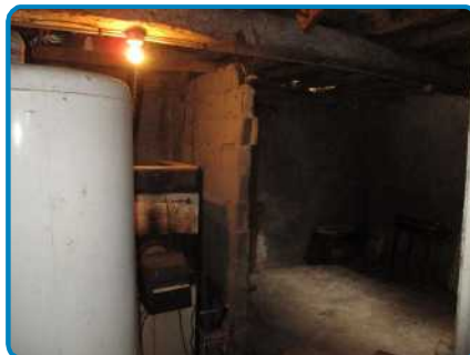
Dépendance Rez de chaussée Chaufferie
