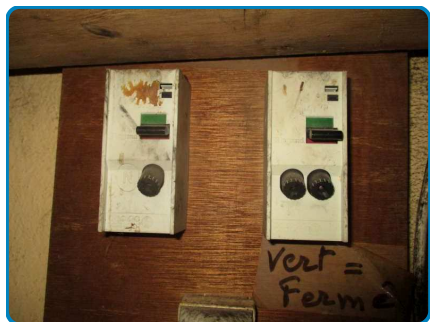
Anomalie B.7.3 e sur Install. n°1
