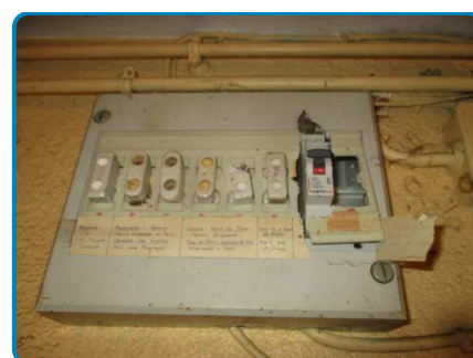
Anomalie B.4.3 b sur Install. n°1 App. n°2 (TRS n°2) Anomalie B.7.3 e sur Install. n°1 App. n°2 (TRS n°2)
