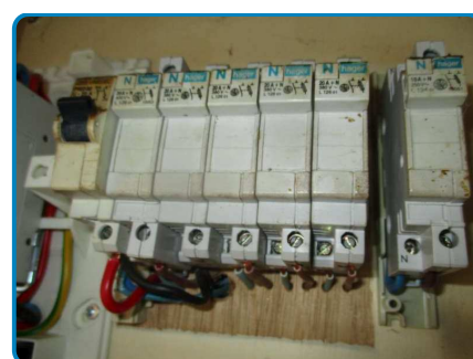
Anomalie B.4.3 e sur Install. n°1 App. n°1 (TRP n°1)
