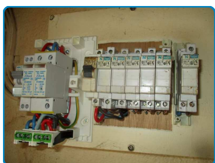
TRP n°1 sur Install. n°1 (dans Maison principale Rez de chaussée Cuisine)
