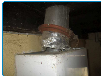
Appareil n°1 (Chauffe-eau) sur installation n°1 (dans Maison principale Rez de chaussée Arrière cuisine)
