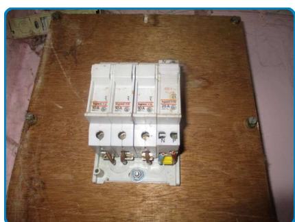
Anomalie B.4.3 e sur Install. n°1 App. n°1 (TRS n°1)
