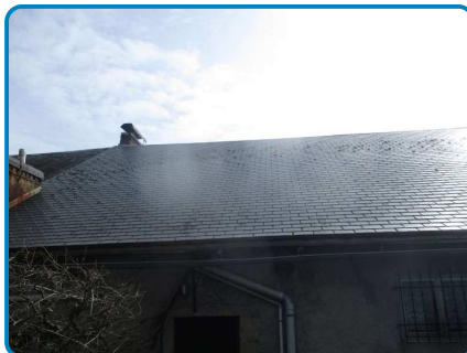
D.O. n° 3 sur Toiture nord Ouest Ardoises fibre-ciment
