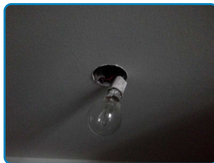
Anomalie B.3.3.6 a3 sur Install. n°1
