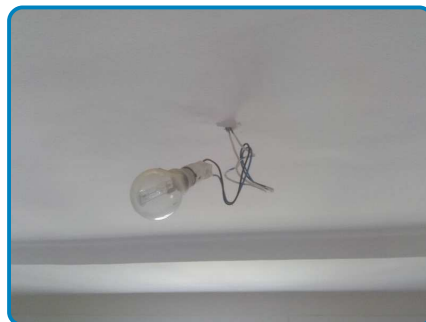
Anomalie B.3.3.6 a3 sur Install. n°1
