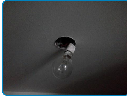
Anomalie B.3.3.6 a3 sur Install. n°1
