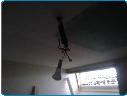
Anomalie B.3.3.6 a3 sur Install. n°1
