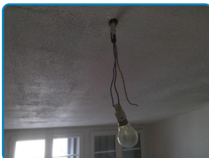
Anomalie B.8.3 e sur Install. n°1 Anomalie B.3.3.6 a3 sur Install. n°1 Anomalie B.7.3 a sur Install. n°1 Anomalie B.7.3 e sur Install. n°1
