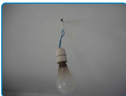
Anomalie B.3.3.6 a3 sur Install. n°1
