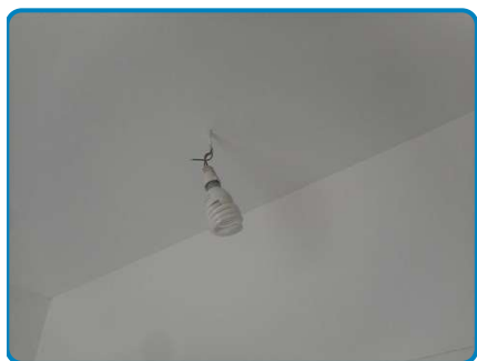
Anomalie B.8.3 b sur Install. n°1
