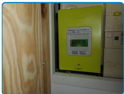
COMPTEUR sur Install. n°1 (dans Rez de chaussée Cage escalier)
