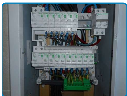
Anomalie B.4.3 f1 sur Install. n°1 App. n°2 (TRP n°2)
