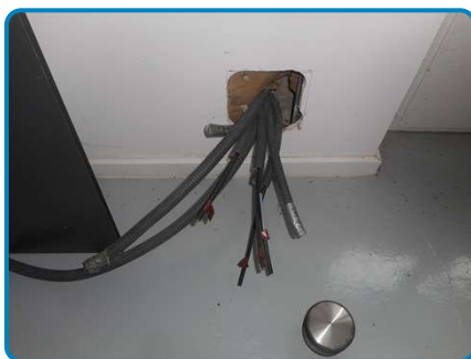
Anomalie B.8.3 e sur Install. n°1
