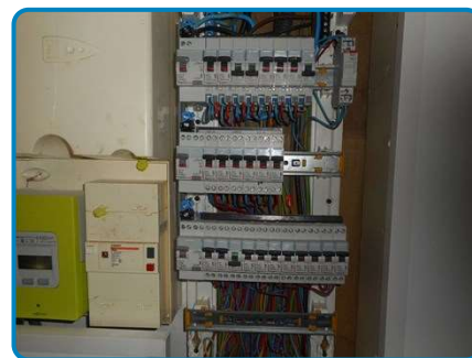
Anomalie B.4.3 f1 sur Install. n°1 App. n°1 (TRP n°1)
