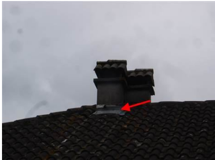
Photo n° PhA006 Localisation : Dépendance - Garage Ouvrage : Toitures Partie d'ouvrage : Accessoires de couvertures (composites) Description : Accessoires de couvertures (composites) Localisation sur croquis : ZPSO-006
