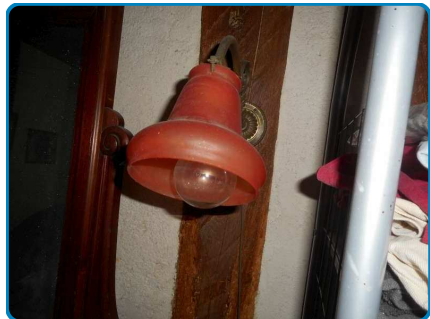
Anomalie B.3.3.6 a3 sur Install. n°1
