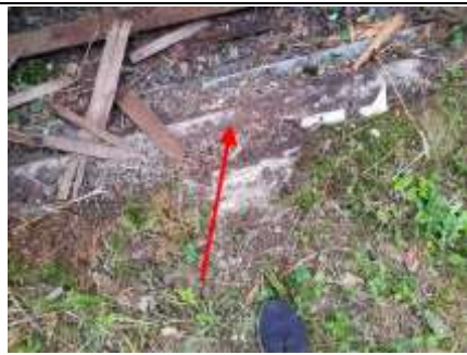
Photo n° A1 Localisation : Extérieur bâtiment Ouvrage : plaque fibrociment amiante M00 stockée au sol
