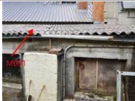
Photo n° A2 Localisation : Atelier/four Ouvrage : Couverture d'une partie de la pièce n onde fibrociment amiante M001
