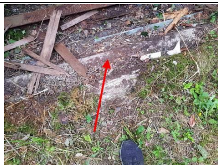
Photo n° A1 Localisation : Extérieur bâtiment Ouvrage : plaque fibrociment amiante M00 stockée au sol M002
