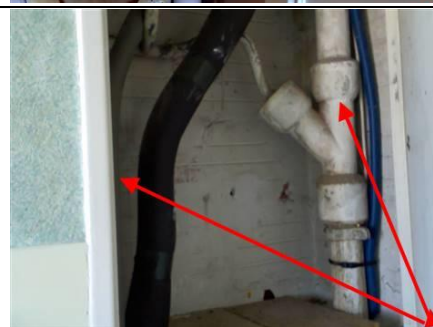
Photo n° PhA002 Localisation : SDB gaine technique Ouvrage : Conduits de fluides (air, eau, autres fluides) Partie d'ouvrage : Conduits Description : Conduits Localisation sur croquis : M002
