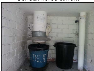
Vide ordures fibres ciment
