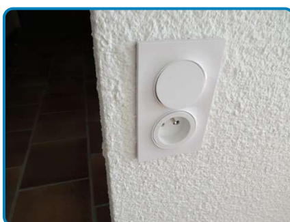
Anomalie B.3.3.6 a2 sur Install. n°1
