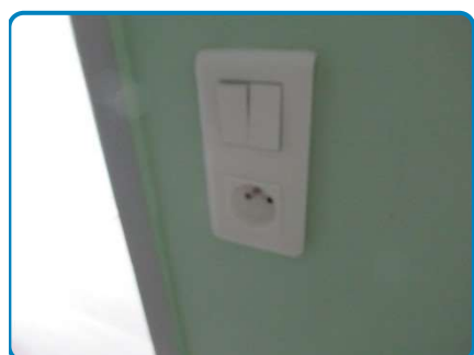
Anomalie B.5.3 a sur Install. n°1 App. n°1
