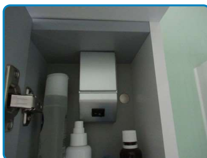
Anomalie B.6.3.1 a sur Install. n°1 App. n°1
