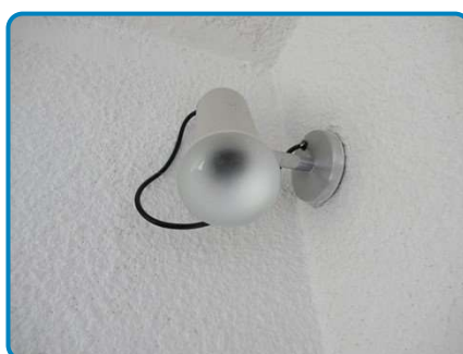
Anomalie B.3.3.6 a3 sur Install. n°1
