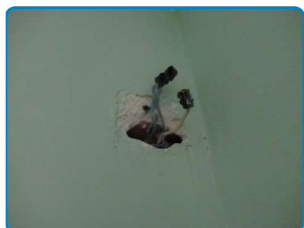
Anomalie B.7.3 d sur Install. n°1
