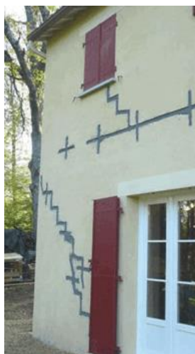
Exemple de traitement de fissures par agrafage
