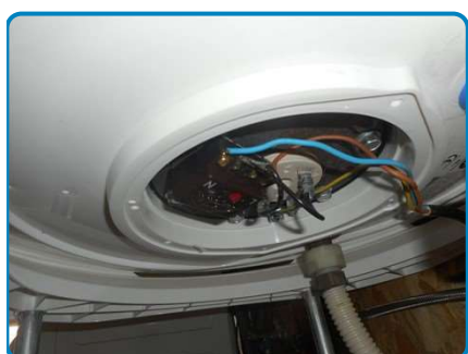
Anomalie B.7.3 a sur Install. n°1
