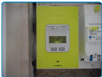
COMPTEUR sur Install. n°1 (dans Rez de chaussée Salle à manger)
