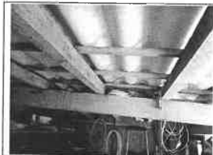
Photo n° A001 Localisation : annexe - cabanon Ouvrage : 1. Toiture, terrasse et étanchéité - Plaques ondulées et planes Partie d'ouvrage : Plaques en fibres-ciment Description : Plaques en fibres-ciment
