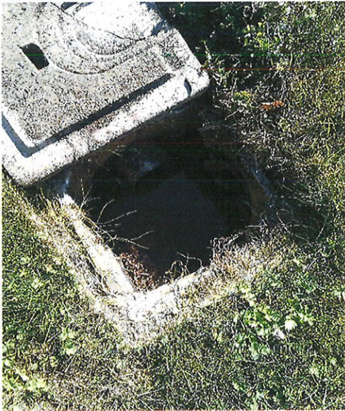
Regard de répartition
