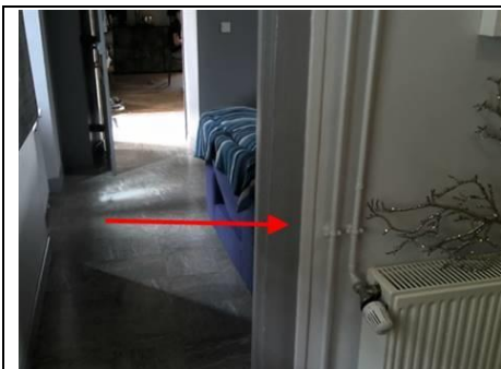
Photo n° PhPb001 Localisation : Rez de chaussée - Séjour UD : Huisserie porte (mesure 1)
