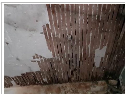
Photo n° T1 Localisation sur croquis : Salle à manger Ouvrage : Dégât des eaux lattis apparent. Structure bois non visible et non accessible exclu du diagnostic.
