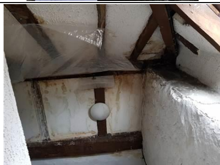
Photo n° T5 Localisation sur croquis : Dégradation due à la non étanchéité de la couverture
