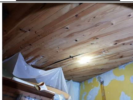
Photo n° T3 Localisation sur croquis : R=2 Ouvrage : plafond lambris dégradé: couverture non étanche aux intempéries
