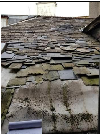
Photo n° T4 Localisation sur croquis : Extérieur bâtiment Ouvrage : couverture dégradée n'assure plus son rôle de protection vis à vis des intempéries. Dégradation importantes des plafonds R+2 et R+1
