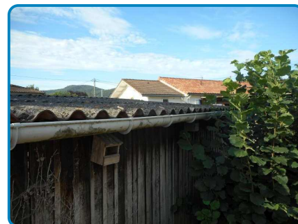
Toiture poulailler Plaques fibres ciment (dans Dépendance Rez de chaussée Extérieur) Toiture auvent Plaques fibres ciment (dans Dépendance Rez de chaussée Extérieur)
