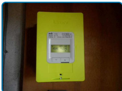
COMPTEUR sur Install. n°1 (dans Maison principale Rez de chaussée Garage)
