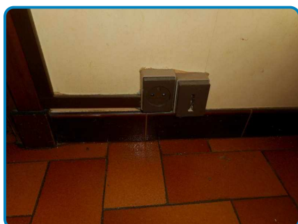
Anomalie B.3.3.6 a1 sur Install. n°1
