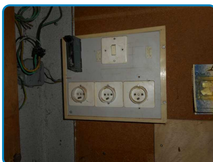
Anomalie B.3.3.6 a2 sur Install. n°1
