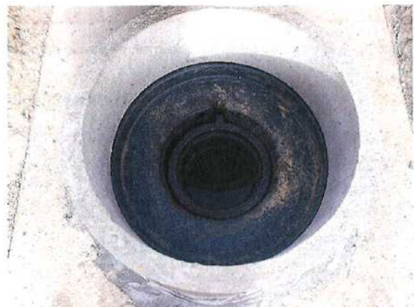
Fosse toutes eaux - Sortie (+ pré-filtre)
