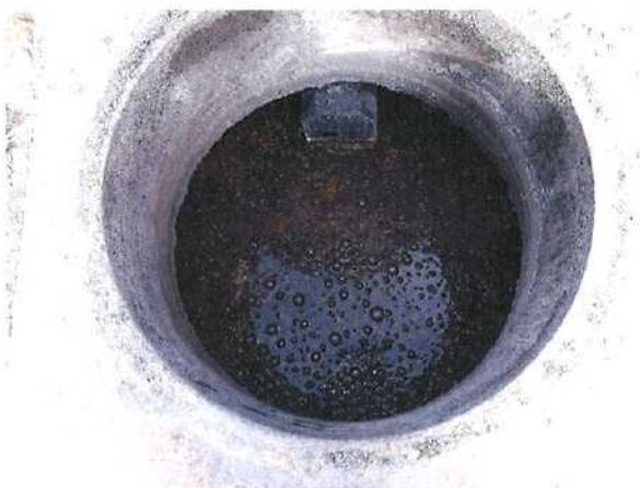
Fosse toutes eaux - Entrée
