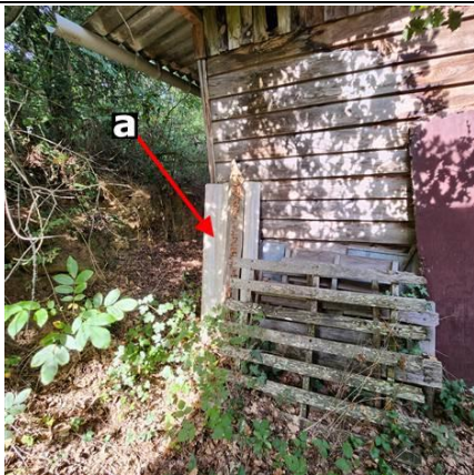
Photo n° PhA004 Localisation : Extérieur - Jardin Ouvrage : 1 - Couvertures, Toitures, Terrasses et étanchéités - Plaques ondulées et planes Partie d'ouvrage : Plaques en fibres-ciment (y compris plaques « sous tuiles ») Description : Plaques en amiante ciment
