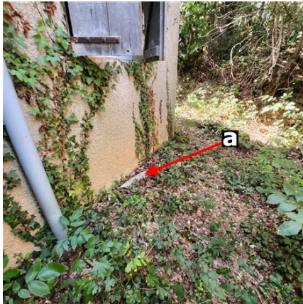
Photo n° PhA004 Localisation : Extérieur - Jardin Ouvrage : 1 - Couvertures, Toitures, Terrasses et étanchéités - Plaques ondulées et planes Partie d'ouvrage : Plaques en fibres-ciment (y compris plaques « sous tuiles ») Description : Plaques en amiante ciment
