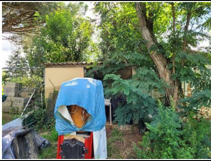
Photo n° PhA003 Localisation : Dépendances - Abris 1 Ouvrage : Toitures Partie d'ouvrage : Plaques (fibres-ciment) Description : Plaques (fibres-ciment)
